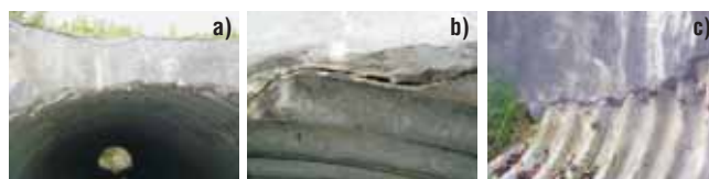
Fot. 7. Stan głowic wlotowych (a - pęknięcia betonu, b - rozszczelnienia pomiędzy rurą stalową i głowicą, c - zacieki na betonie)
