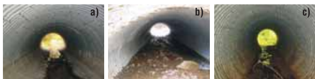
Fot. 9. Stan dna i spadek przepustu (a - dno bez zanieczyszczeń, b - dno przepustu z narzutem kamiennym, c - niewielkie zanieczyszczenia dna przepustu)
