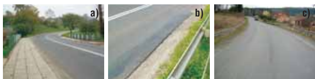
Fot. 11. Stan nawierzchni jezdni nad przepustem (a - brak deformacji nawierzchni nad przepustem, b - niewielkie ubytki i deformacje nawierzchni, c - bardzo dobrze utrzymana nawierzchnia nad konstrukcją podatną)
