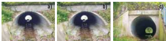
Fot. 10. Kształt przekrojów poprzecznych konstrukcji podatnych (a - przekrój łukowo-kołowy wylot, b - przekrój łukowo-kołowy wlot, c - niewielka deformacja przekroju poprzecznego przepustu)
